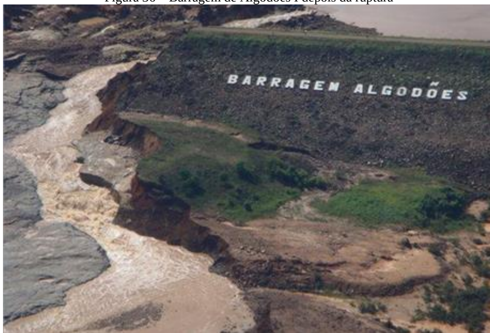
Figura 36 – Barragem de Algodões I depois da ruptura
